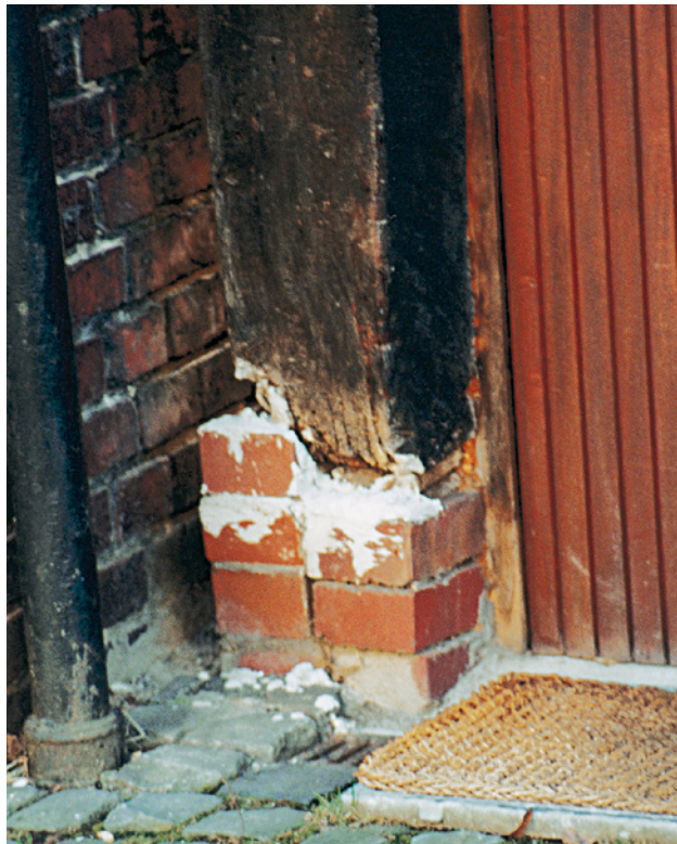
Abb. 4: Der unten abgefaulte Eckständer wurde primitiv untermauert; Fehlstellen wurden mit Mörtel gefüllt, der jedoch größtenteils schon wieder herausgefallen ist.
