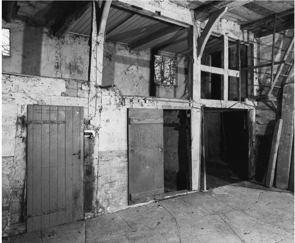
Abb. 5: Deele vor der Restaurierung: Der erste Eindruck täuscht über den tatsächlichen Zustand der noch intakten Fachwerk- konstruktion hinweg.
